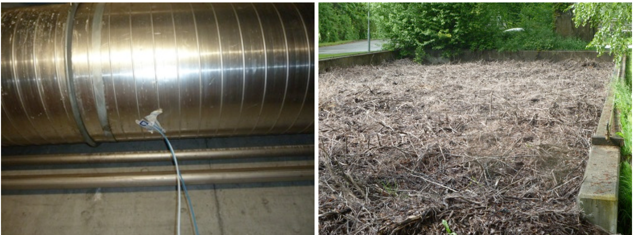
Abbildung 13: Messstellen in der Zuluft zum Biofilter (links) und in der Abluft vom Biofilter (rechts).
