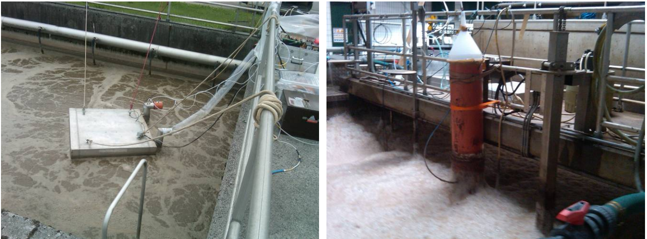
Abbildung 10: Abluftmessung mit Messhaube bei der Schwachlastbiologie (belüfteter Teil, links) und mit Messzylinder bei der Prozesswasserbehandlung (Schaumbildung bei Belüftung, rechts).
