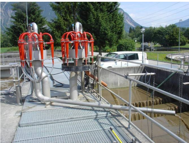
Abbildung 14: Zyklone zur Abtrennung der Anammoxbiomasse aus dem Überschussschlamm.
