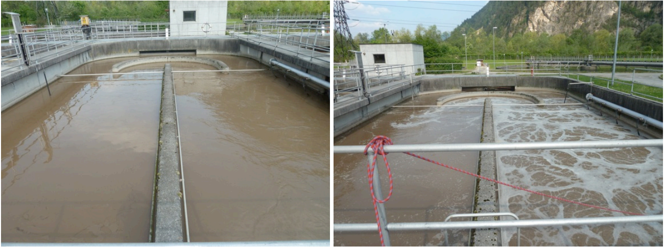
Abbildung 12: Messstellen in der Schwachlastbiologie: Denitrifikationsbecken (links) und Nitrifikationsbecken mit belüftetem und unbelüftetem Bereich (rechts).
