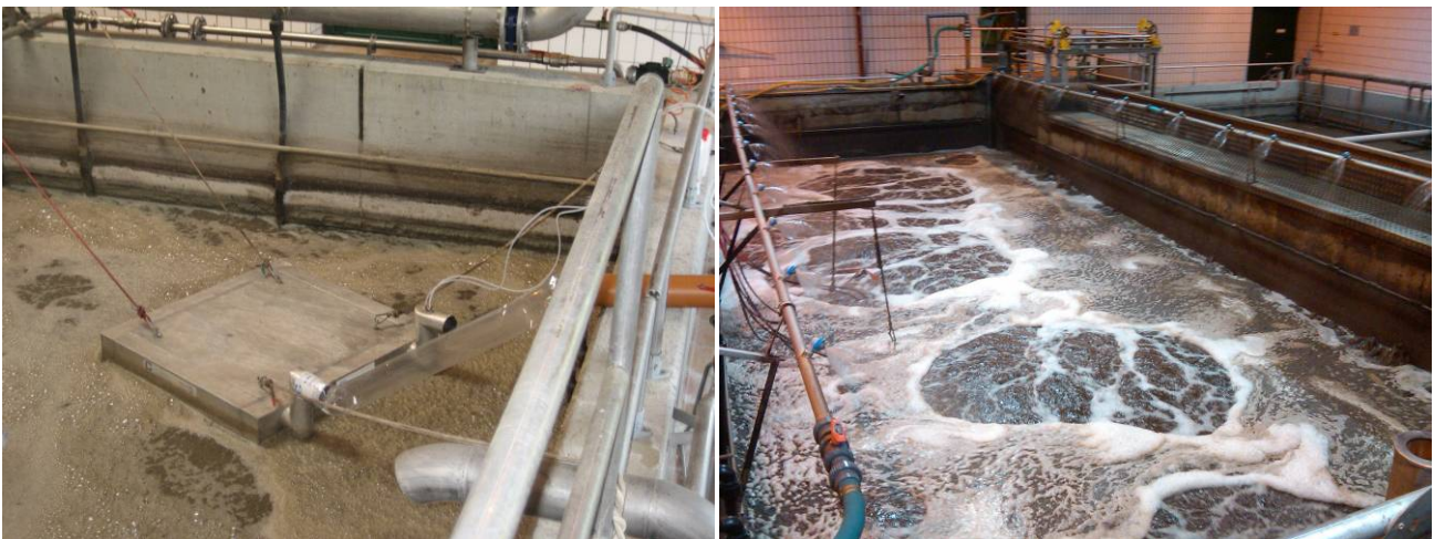
Abbildung 11: Abluftmessung bei der Hochlastbiologie. Der Hochlastreaktor befindet sich neben der Prozesswasserbehandlung (links, Hochlast im Hintergrund).
